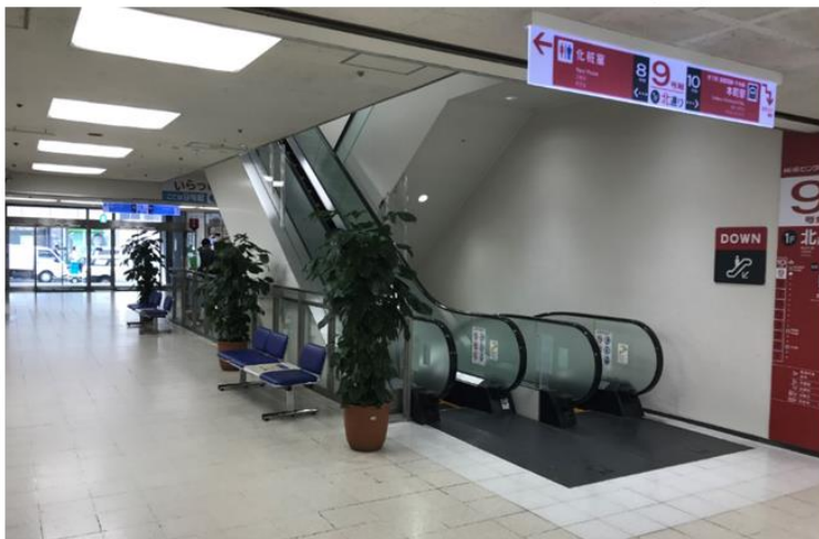
納入済みエスカレーター(9号館)
